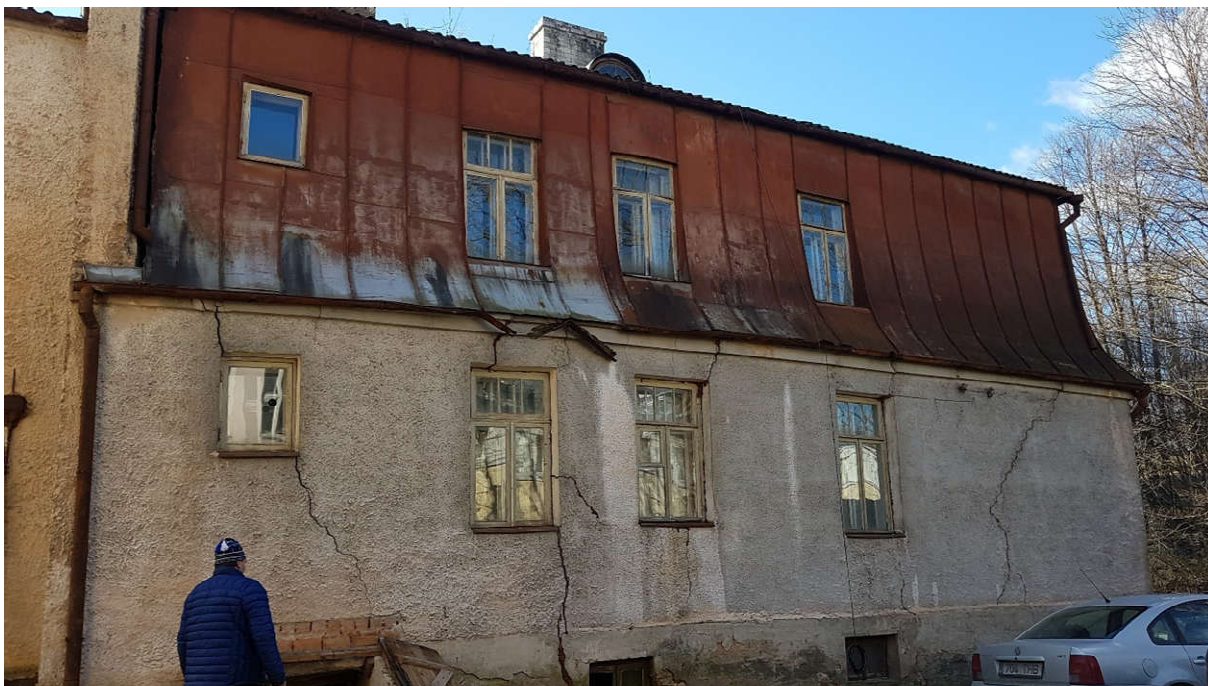
Pilt 10. Lossi tn 11 tänaseks lammutatud hoone idafassaad lagunenu mansardkatuse ja pragudega seinas. Sissepääs keldrisse on näha hoone vasakus nurgas inimfiguuri juures. Pilt Mart Hiob 2017.
